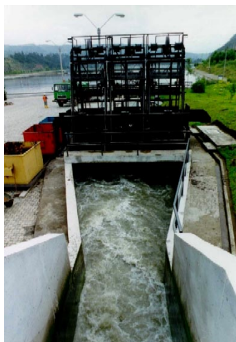
FOTOGRAFIA N° 3.2: Cribas mecánicas autolimpiantes
