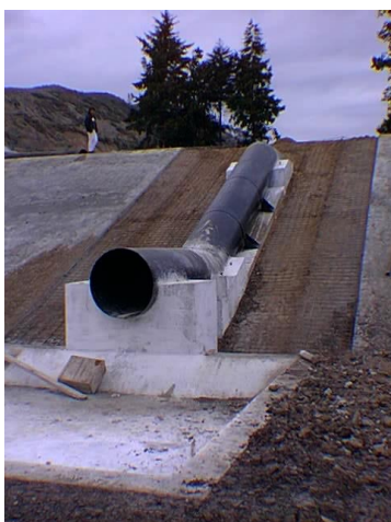
Edificación de Estructura de Ingreso de Agua Residual hacia Lagunas - Vista de Estructura para evitar Erosión y Socavación de Fondo de Lagunas - Octubre de 1997
