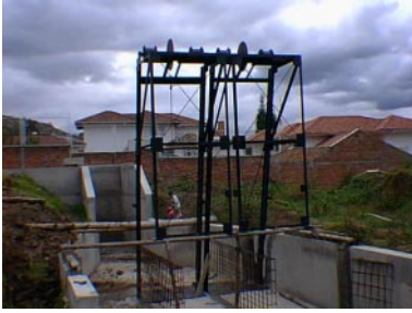
Edificación de canales de transición y conducción de Cribas Mecánicas Autolimpiantes – Implantación de Cribas Mecánicas Autolimpiantes – Abril de 1997
