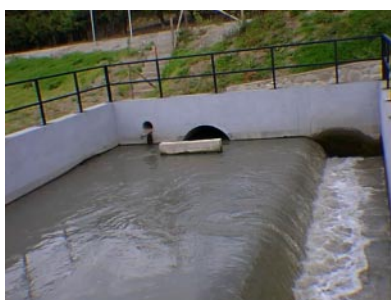
By-pass en Cajón de Llegada en etapa de prueba y evaluación – Agosto de 1998
