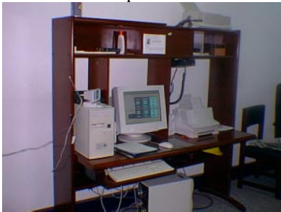
Pruebas y Calibraciones en Sistema de Monitoreo, Control y Mando de la PTAR – Diciembre de 1999
