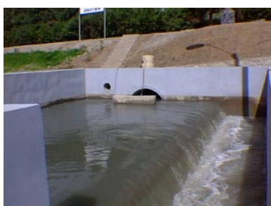
Una vez terminadas las obras en el Emisario Final y su implantación y edificación total, a finales del año 1997, las aguas residuales fueron conducidas mediante esta estructura hacia el cajón de llegada de la PTAR, consiguiéndose la descontaminación de tres kilómetros adicionales de río, y en este caso específico el tramo comprendido entre la junta de los ríos Tomebamba y Machángara hasta la PTAR ubicada en Ucubamba - Abril de 1998
