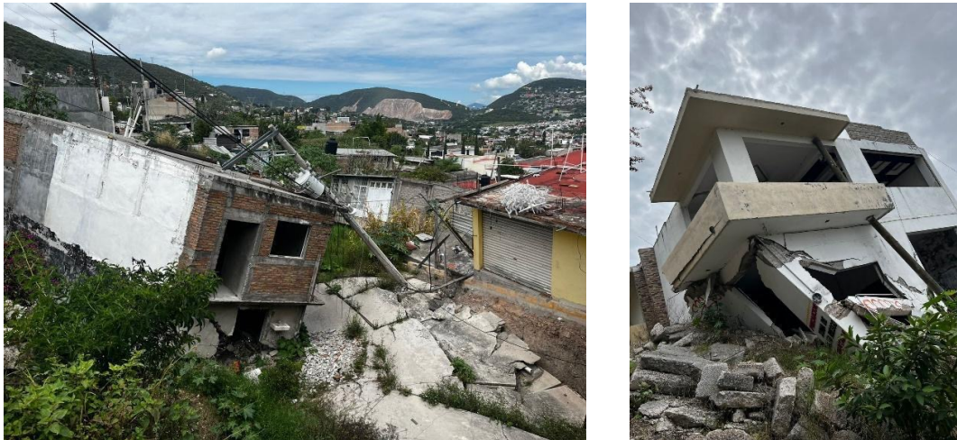
Figura 2. Colonias críticas que presentan viviendas con daños críticos
